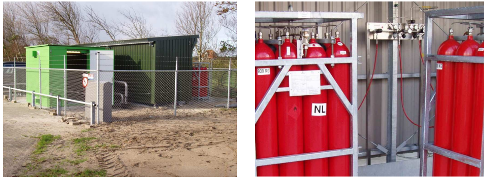
Figuur 2: Menginstallatie gevoed met waterstof uit flessenpakketten
