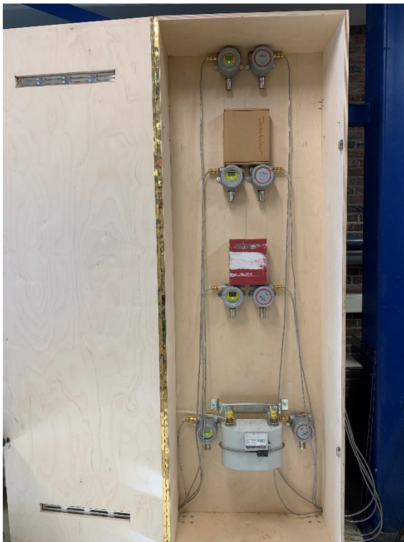
Figuur 2A: Meterkast, voorzien van een niet-werkende gasmeter, kartonnen dozen als alternatief voor de elektriciteitsmeter en waterstof- en CH 4 -sensoren.
