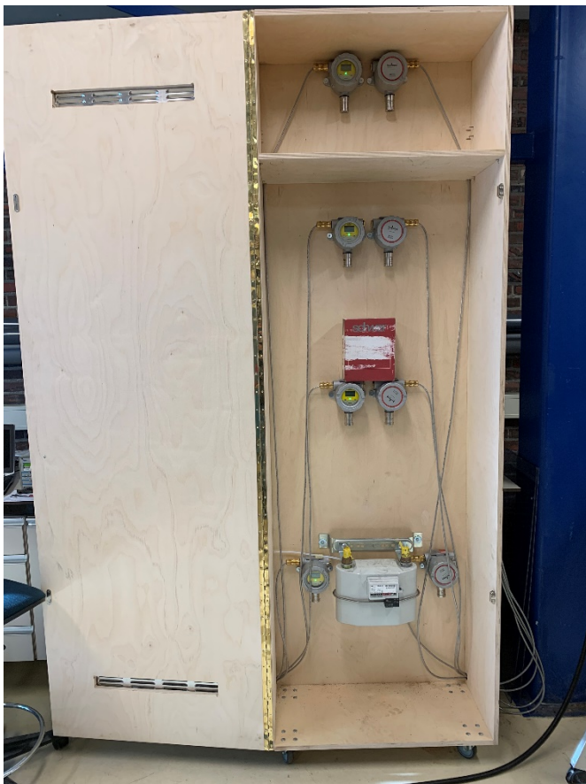
Figuur 2B: Geopende meterkast met plafondplaat
