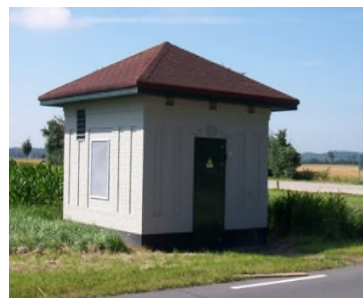
Voorbeeld van transformatorhuisje
