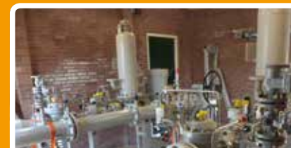
De nieuwe reduceerstraten zijn in het gasontvangstation geplaatst
