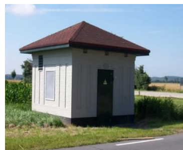
Voorbeeld van transformatorhuisje
