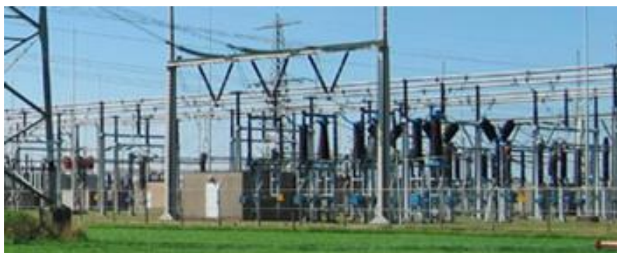
Figuur 2.2: Foto hoogspanningsstation
