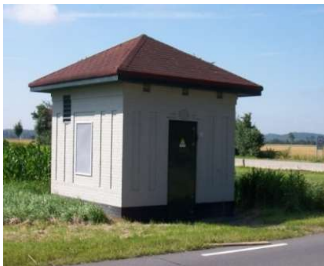
Voorbeeld van transformatorhuisje
