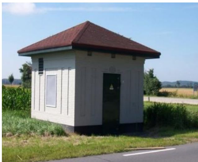
Voorbeeld van transformatorhuisje
